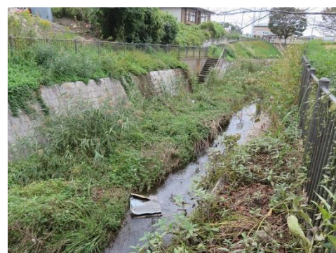
上富士川にトタン製の扉が落ちて 落ちている
